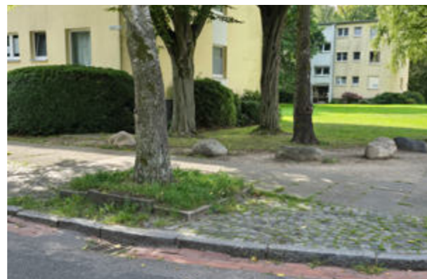
Abb. 22 und 23: Schadensbilder: 1. Falscher Standort: Baum zwischen zwei Zufahrten. Vergrößerung der Baumscheibe nicht möglich. Georg-Gröning-Straße. 2. Zu kleine Baumscheibe mit Hochbord eingefasst in der Adolf-Reichwein-Straße. Vergrößerung auf 9,5 m x 1,5 m möglich. Fotos: SUKW / Iris Bryson.
