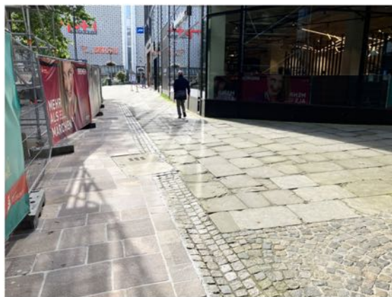
neue Porphyr-Platten am Lloydhof (links) & vorh. Sandsteinplatten vor Apperath-Cüpper (rechts)
